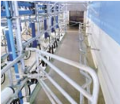
Las barras traseras y delanteras aseguran una carga fluida de la sala.
